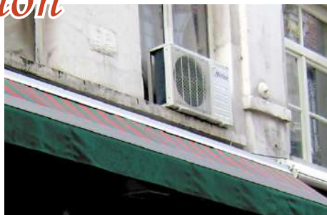
Un mauvais exemple d'installation technique
