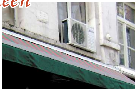
Een slecht geplaatste technische installatie
